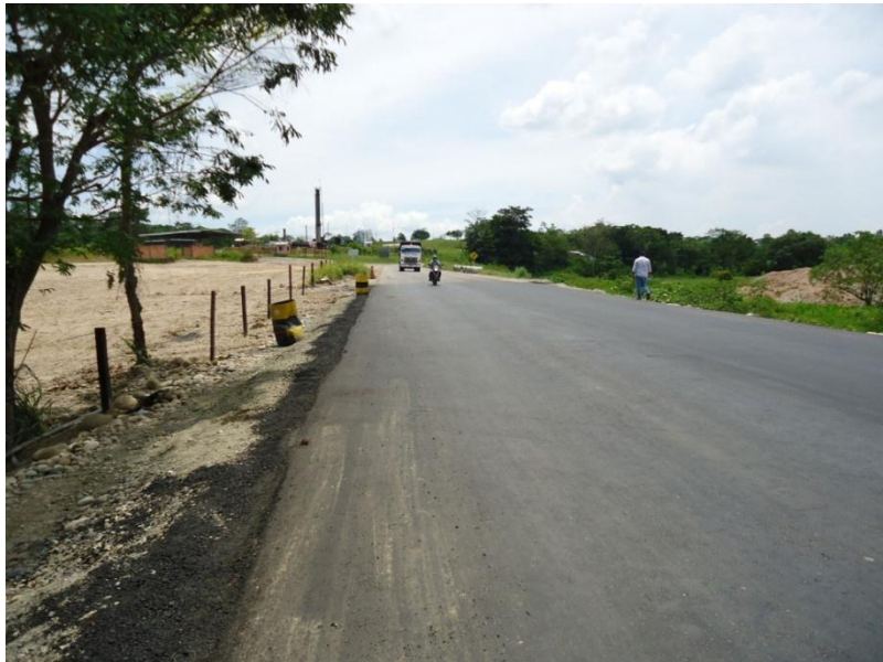
Fuente: UT Mantenimientos 2005.
