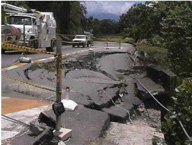
Foto 2. Daños en el corredor 2005.
