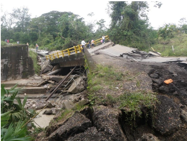
Foto 14. Ruta 6602, Colapso puente La Leona: UT Mantenimientos 2005.
