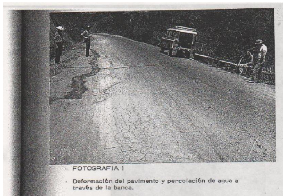
Foto 1. Daños en el corredor 1975.
