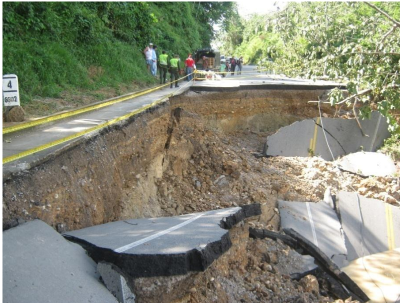
Fuente: UT Mantenimientos 2005.
