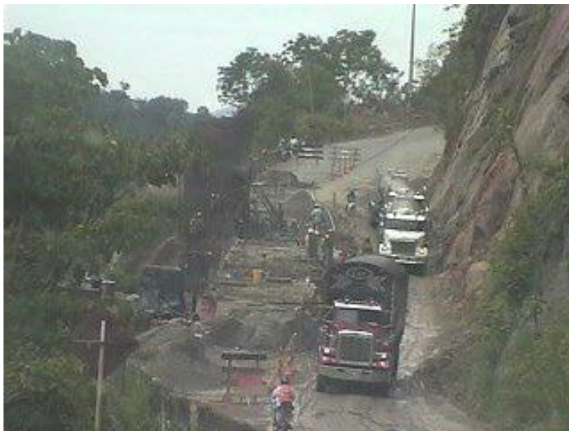
Foto 3. Daños en el corredor 2005.
