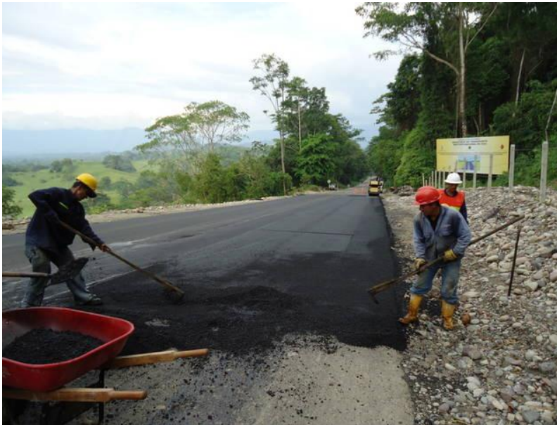
Fuente: UT Mantenimientos 2005.
