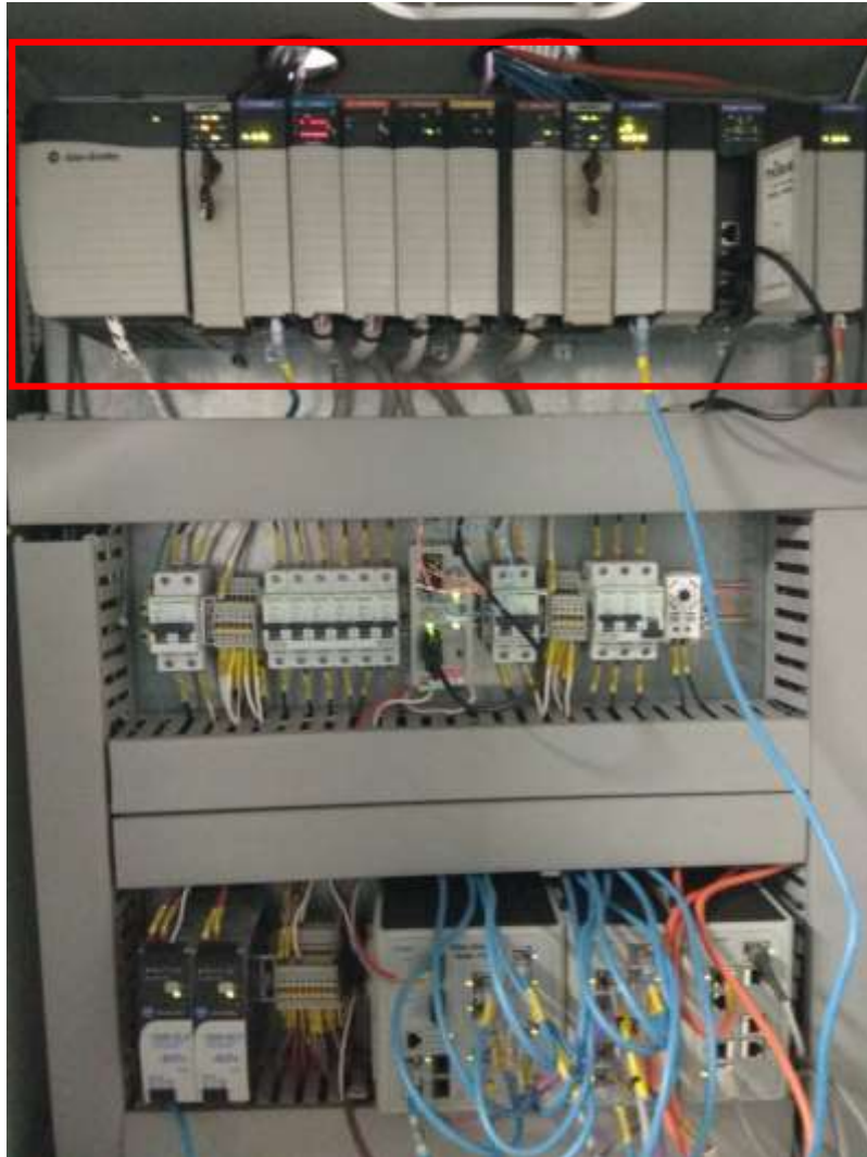
Ilustración 32: PLC Control Logix SCC – Tarjeta de comunicaciones Prosoft.
