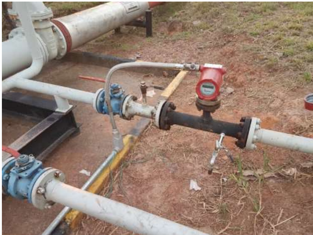
Ilustración 27: Medidor Red Eye instalado en clúster A.
