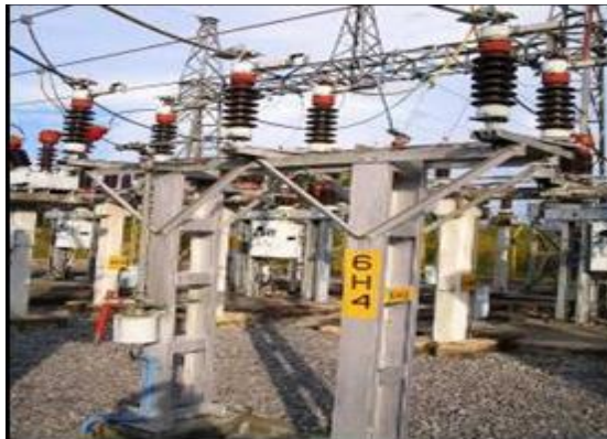
Figura 19. Seccionador de dos columnas con una apertura 34,5kV
