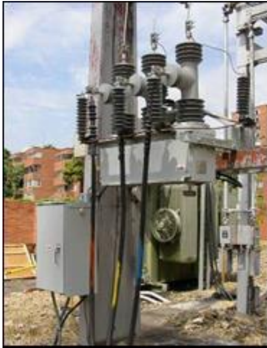
Figura 22. Recloser OVR 38kV
