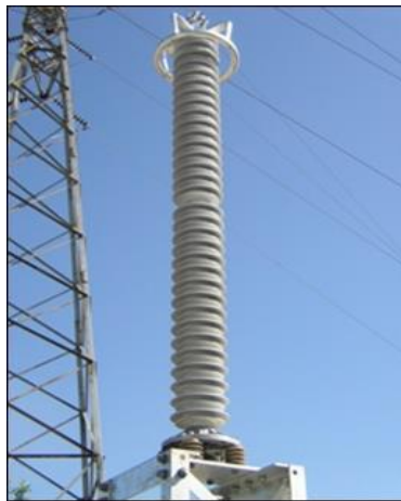
Figura 25. Pararrayos Epóxico de 230 kV
