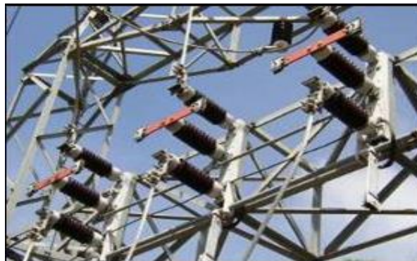
Figura 17. Seccionador de tres columnas con doble apertura 34,5 kV
