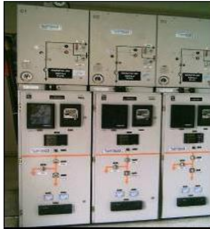
Figura 16. Celda AEG WIA de 34,5 kV
