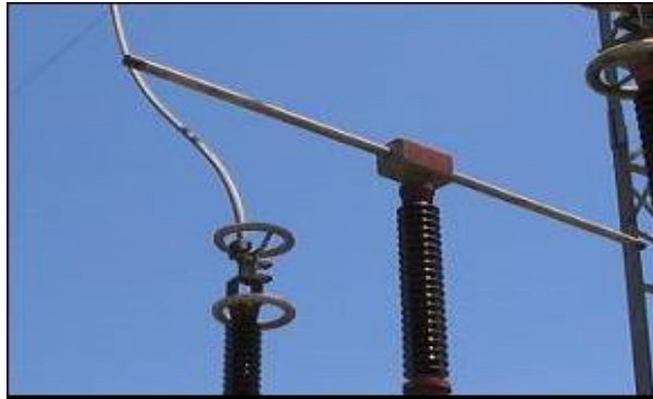
Figura 18. Seccionador de tres columnas con doble apertura 230kV.
