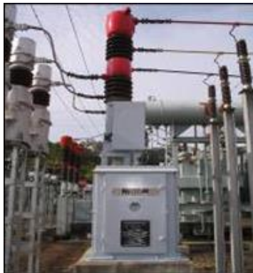
Figura 2. Interruptor DELLE ALSTHOM HPGE 9/14C 34,5 kV
