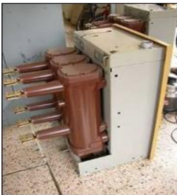
Figura 14. Celda MERLIN GERIN uso tipo interior Vista Lateral
