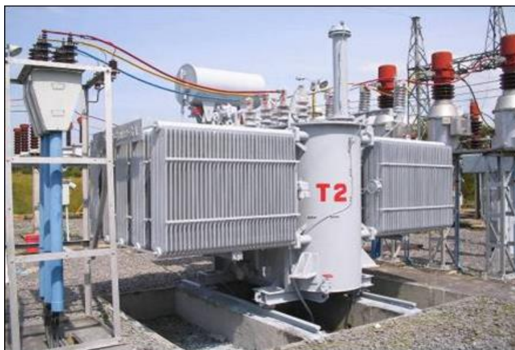
Figura 24 Transformador de 34.5/13.8 kV
