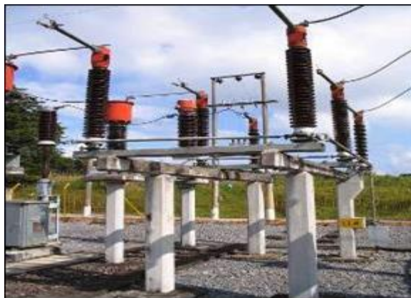
Figura 20. Seccionador de dos columnas con una apertura 115kV
