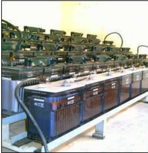
Figura 27. Banco de Baterías
