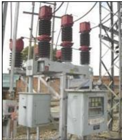
Figura 4. Interruptor ASEA HLC 36-52/1250 B 34,5Kv
