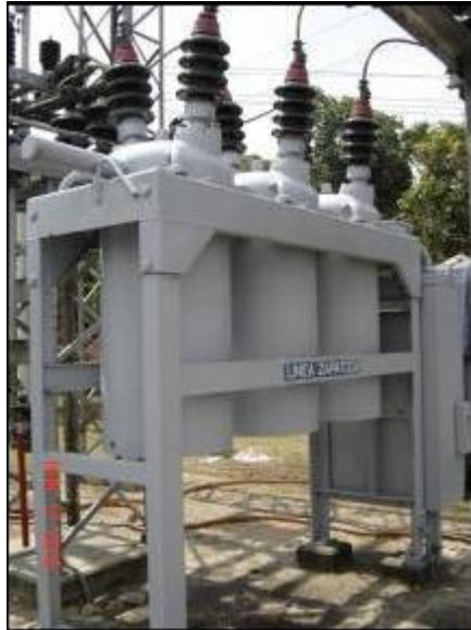
Figura 12. Interruptor WESTINGHOUSE DE 34,5 kV con medio de extinción de aceite
