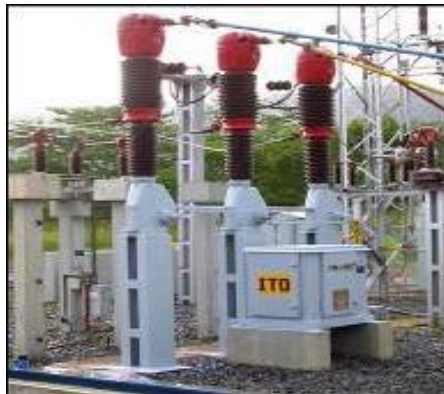
Figura 5. Interruptor DELLE ALSTHOM 7/12 34,5 KV
