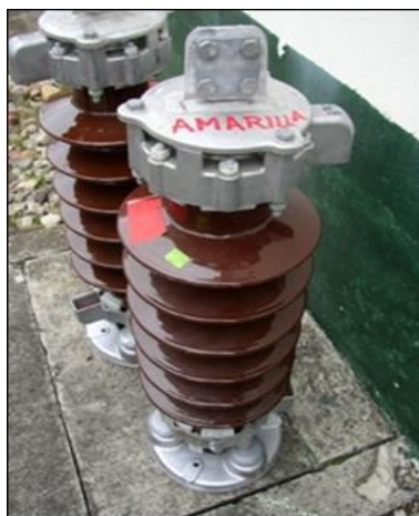
Figura 26. Pararrayos en porcelana de 34,5kV
