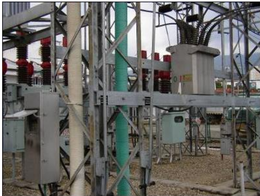
Figura 23. Recloser Nu Lec 34,5 kV
