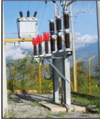
Figura 7. Interruptor de 34,5Kv SF6 Tipo EDFSK1-1 –Mando Resorte
