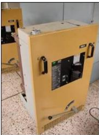
Figura 13. Celda MERLIN GERIN uso tipo interior Vista Frontal
