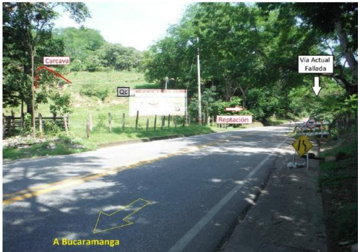
Fotografía 24. Deposito coluvial sobre el eje de la vía
