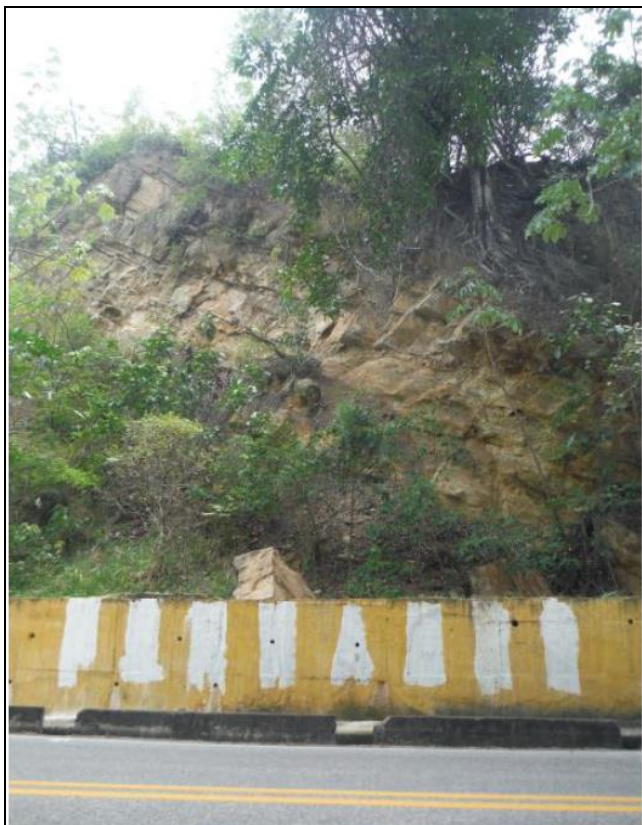
Fotografía 20. Caída de rocas en contrapendiente estructural (Dmo).
