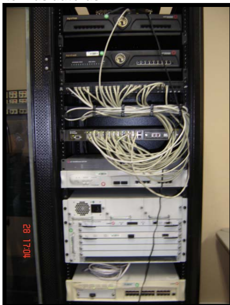
Figura 5. Racks de Comunicaciones del Laboratorio de Redes de Datos de la E3T. Fuente: Las autoras
