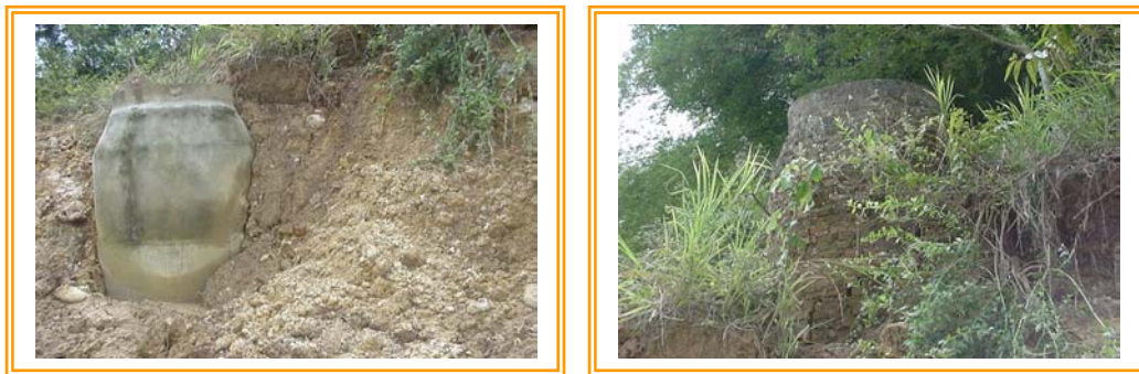
Figura 24. Daños en los Colectores de la Transversal del Porvenir
