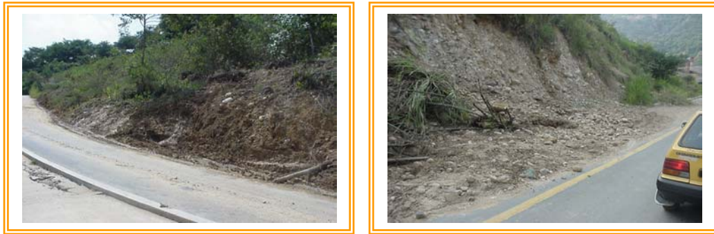
Figura 22. Derrumbes sobre la Calzada de la Transversal del Porvenir
