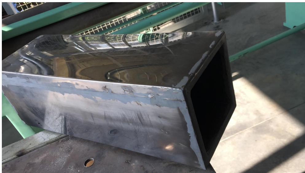
Figura 41. Túnel con macilla para su posterior pintura.
