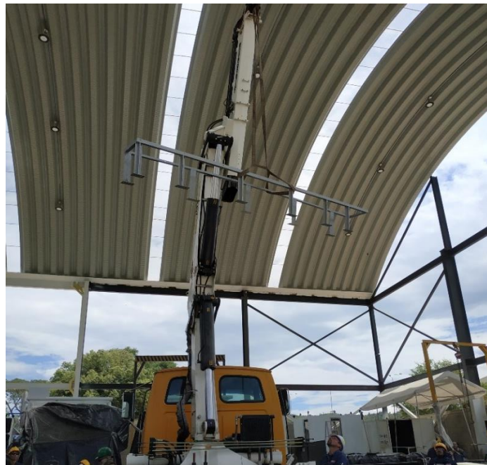
Figura 7. Elevación de racks de mangueras.
