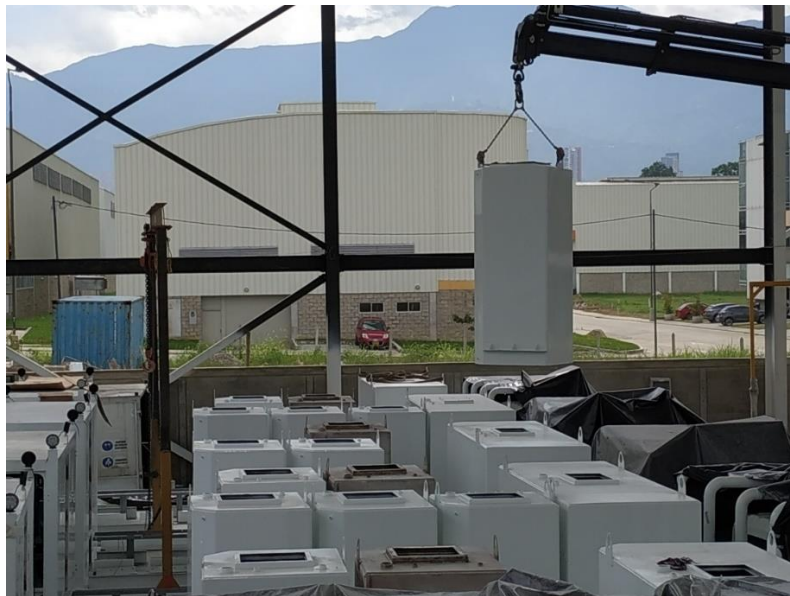
Figura 3. Elevación de tanques de aceite
