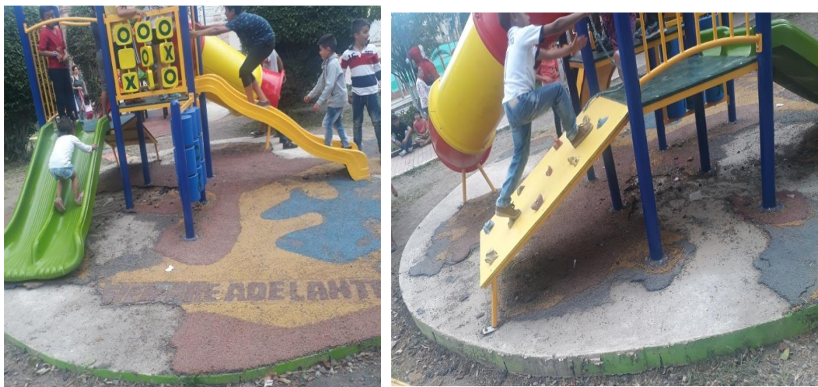
Figura 12. Evidente deterioro en el tapete del parque para la primera infancia.
