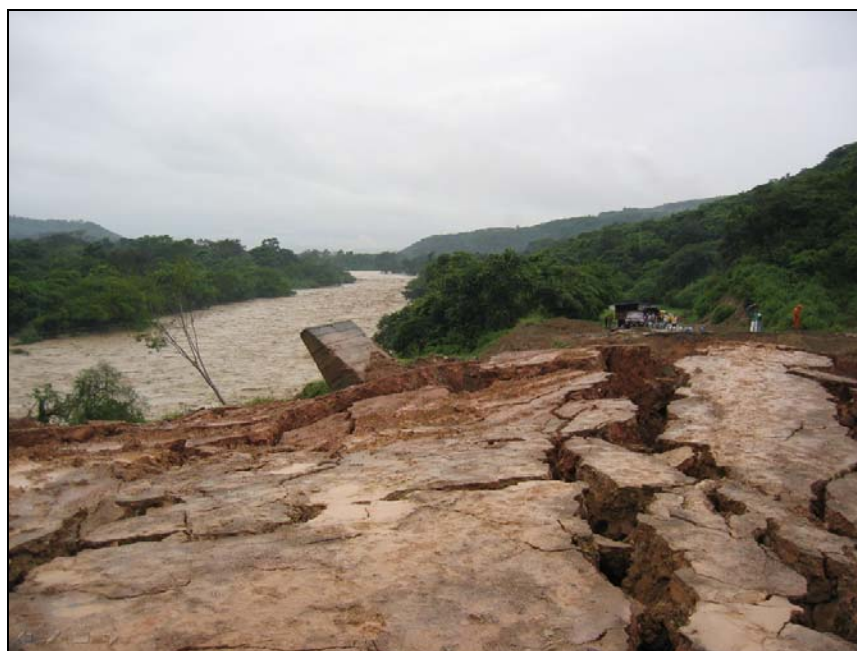
Foto 2. Panorámica nivel alto del río Pamplonita y falla de la vía.
