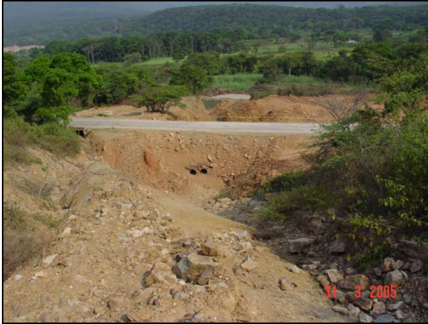
Foto 5. Panorámica del sector norte del deslizamiento, foto en dirección al oriente. Al fondo se observan los depósitos aluviales del Río Pamplonita.
