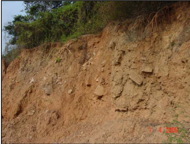
Foto 4. Depósito de Coluvión localizado en la parte alta de la zona del deslizamiento, el cual presenta en la parte superior una corona de desprendimiento antigua.
