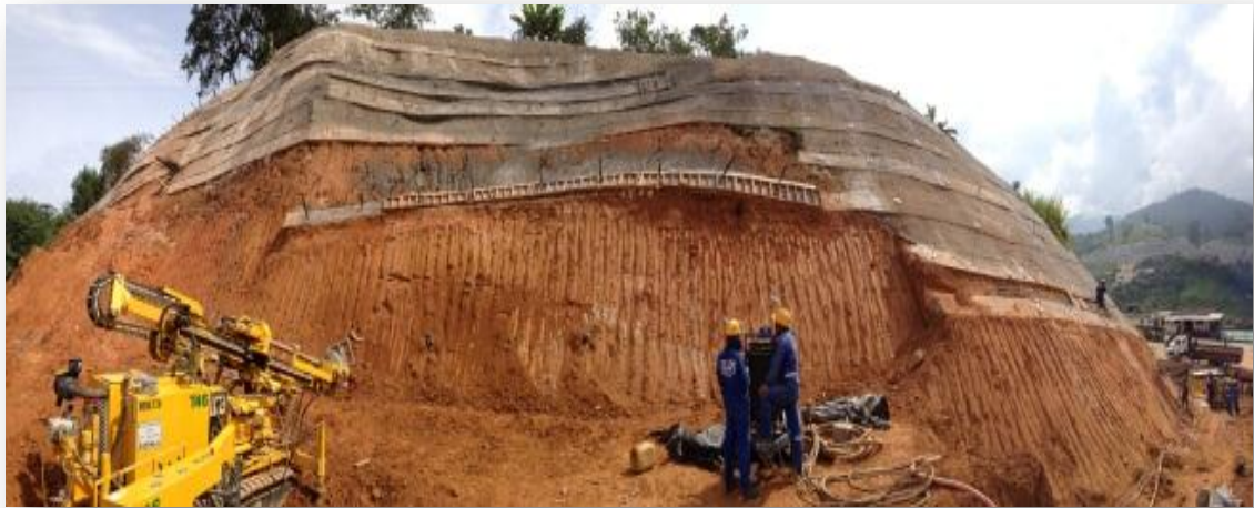
Imagen 1. Proceso de estabilización de talud K10+700 vía Bucaramanga – Cúcuta. Consorcio vías nacionales.
