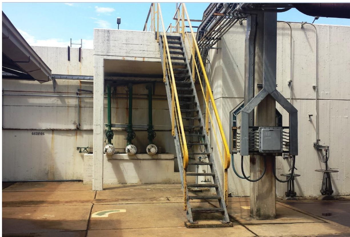
• FIGURA A. Clarificador CL-2911
