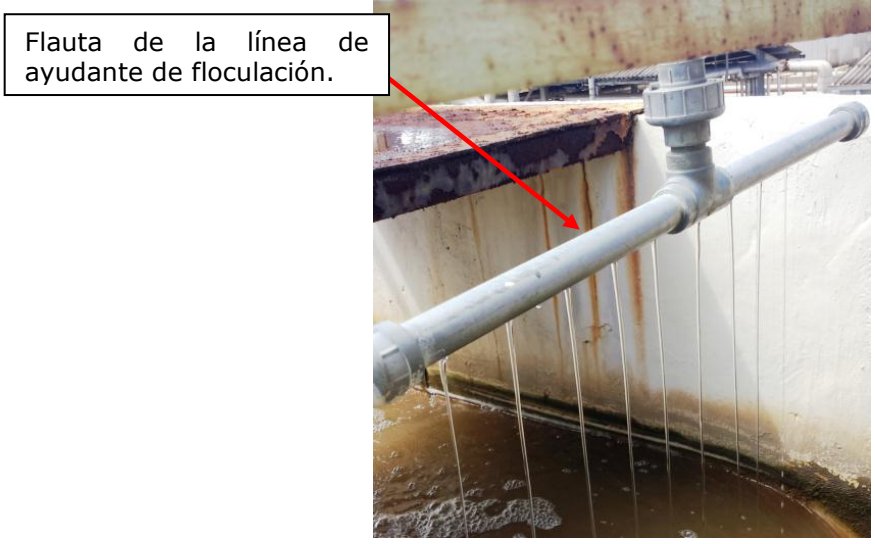
FIGURA 10. Línea de llegada de suministro de ayudante de floculación al clarificador.
