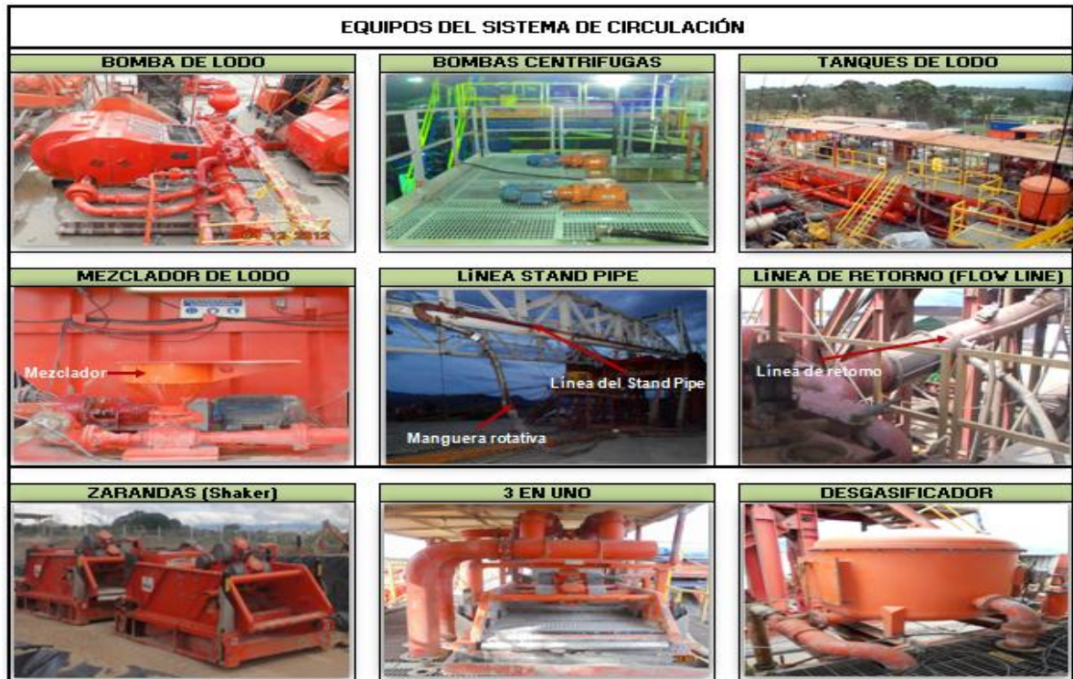
Figura 9. Equipos del sistema de circulación. Equipo de perforación EVSA
