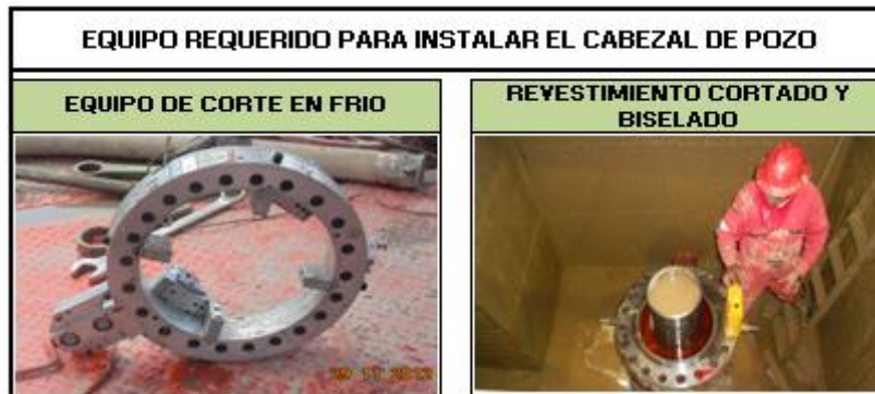
Figura 24. Equipo para instalar cabezal de pozo
