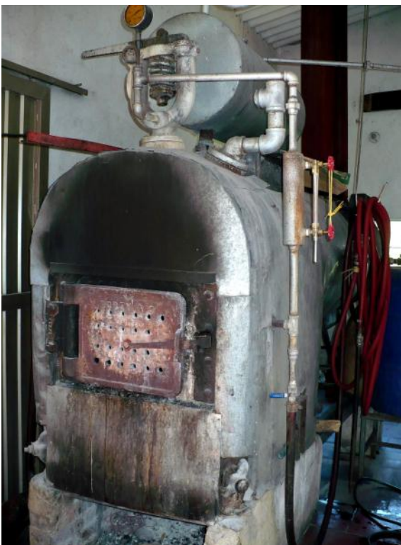
Fig. 18 Caldera de Carbón.
