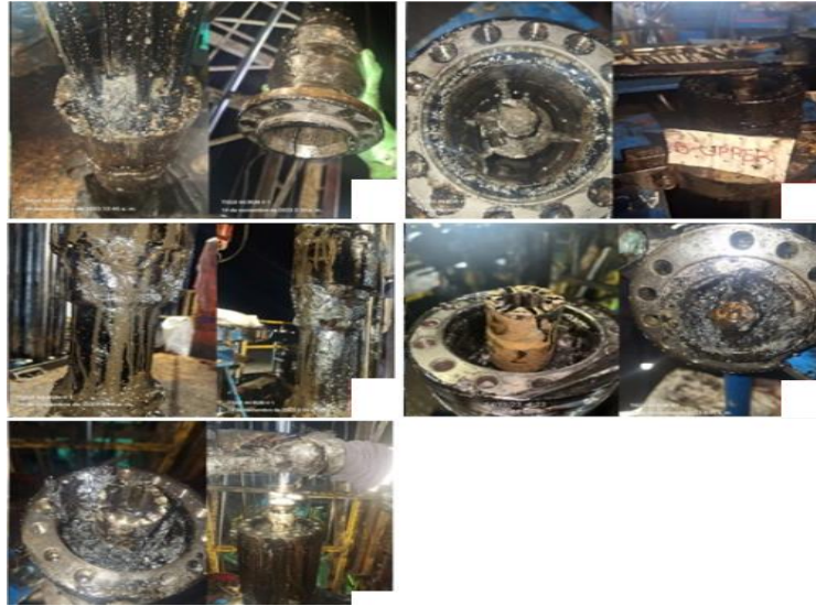
Ilustración 2. Fotografías fallas bomba Pozo SGP-48. Fuente: Empresa encargada de análisis.
