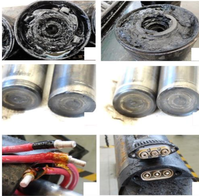
Ilustración 3 Fotografías falla bomba pozo SGT-16. Fuente: Empresa encargada de estudio.
