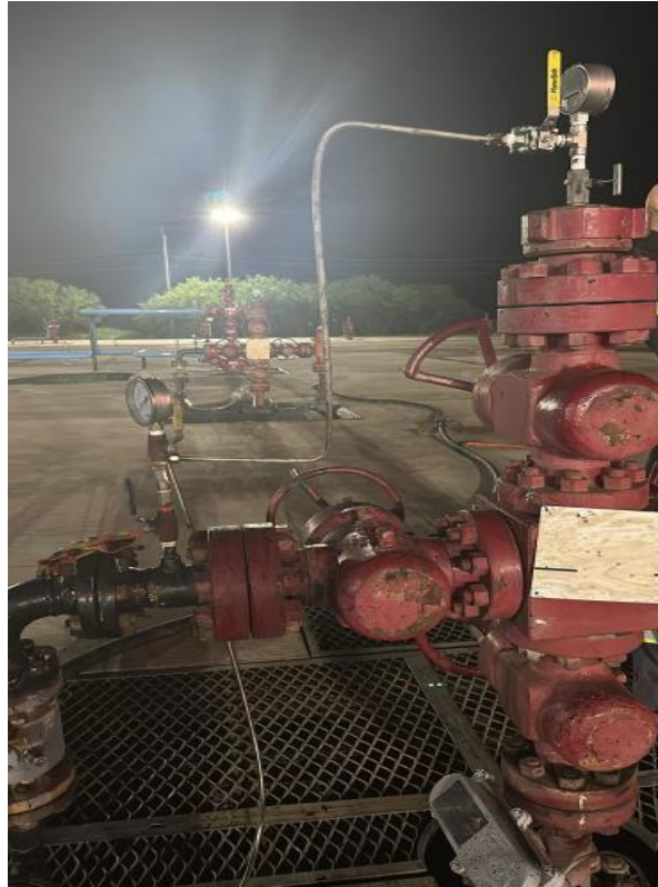
Ilustración 15. Arme en cabeza de pozo para inyección de química continua en los pozos SGPT-16 y SGP-48.
