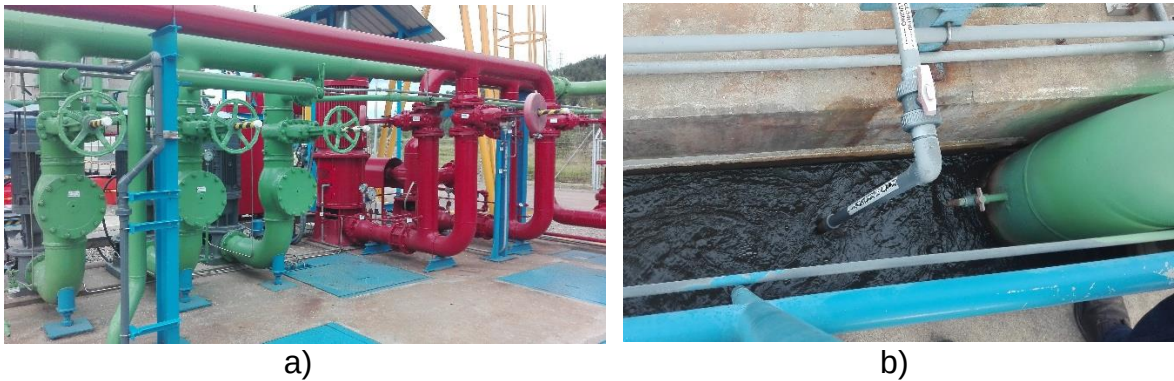
Figura S.3. a) Bombas de dosificación de agua bruta a clarificación. b) Cámara de mezcla.
