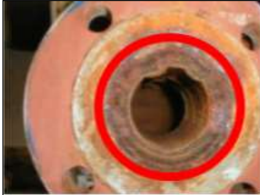
Figura 5. Depósito de Carbonato de Calcio (A Pierre, 2013)
