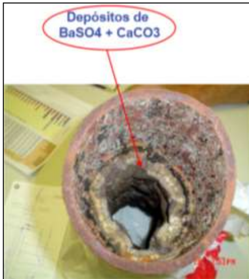
Figura 6. Depósito de Carbonato de Calcio y Sulfato de Bario
