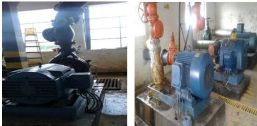
Figura 13. Estado de señalización dentro de la estación de bombeo
