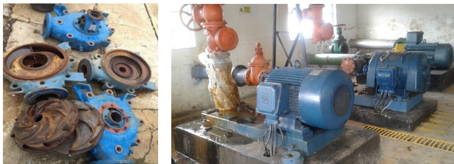
Figura 28. Estado actual de las bombas de 14 pulgadas
