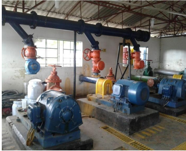
. Figura 21. Cuarto de bombeo para la línea de 14 pulgadas.
