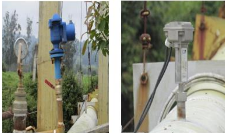
Figura 11. Manómetro, válvula de ventosa y sensor
