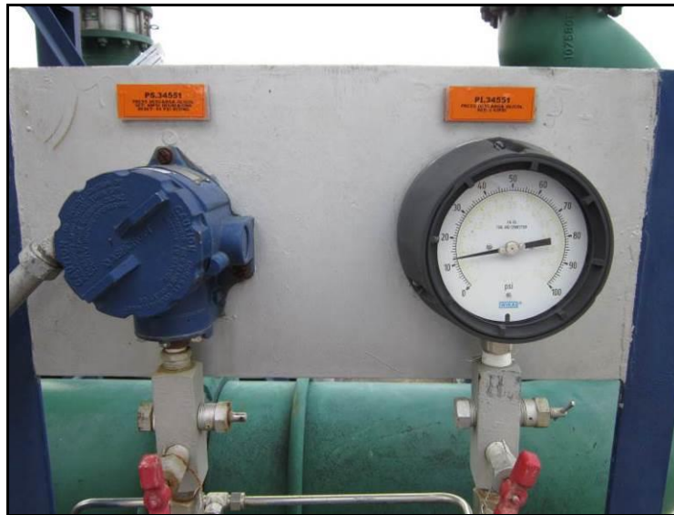
Figura 18. Interruptor de presión PS 34551 y PI 34551
