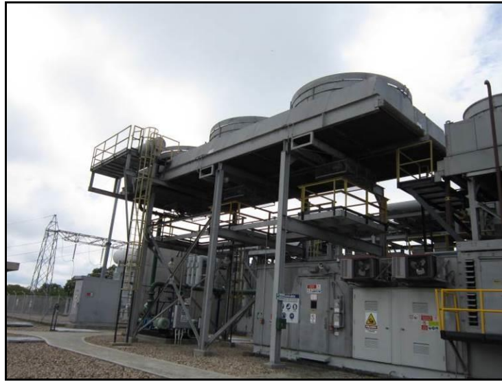
Figura 11. Intercambiador de calor Aire-Glicol
