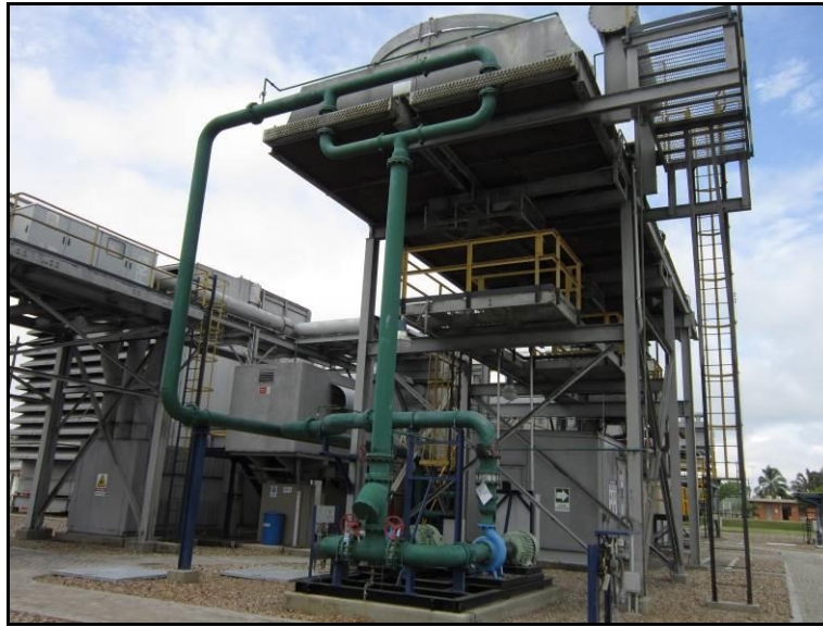
Figura 9. Sistema de enfriamiento Glicol.
