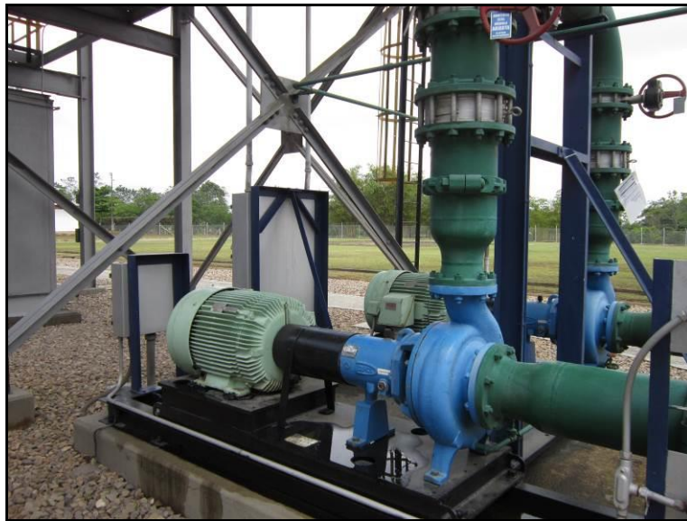
Figura 13. Skid de Bombas
