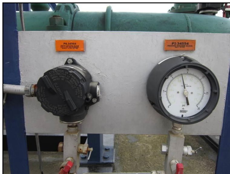
Figura 17. Interruptor de presión PS 34554 y PI 34554
