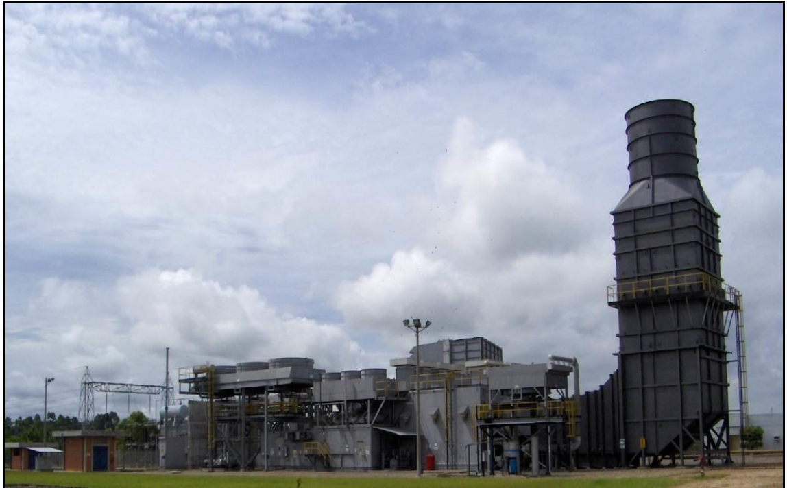
Figura 6. Unidad Termo Meriléctrica 169 MW
