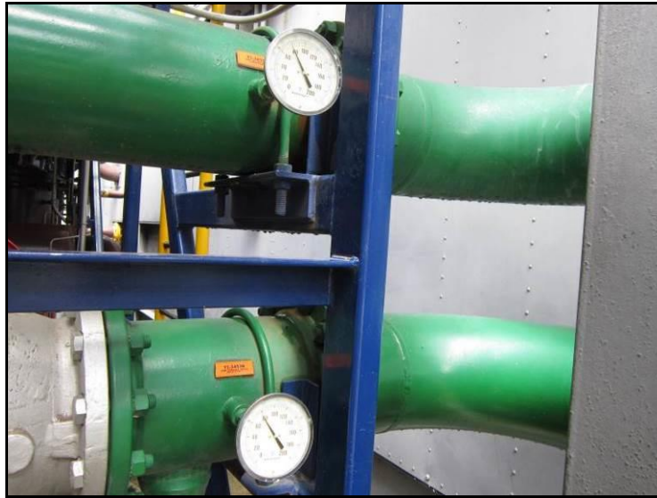
Figura 15. Indicadores de temperatura entrada y salida.
