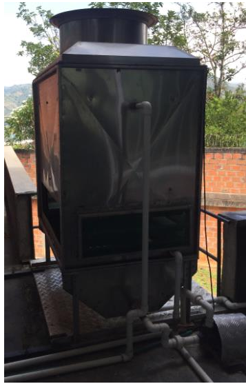
Figura 5: Torre de enfriamiento.
