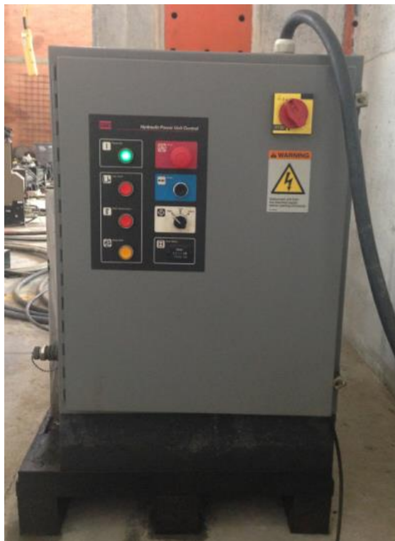
Figura 3: Unidad de potencia.
