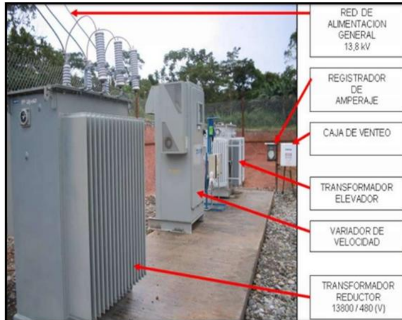
Figura 13: Equipos de superficie BES
