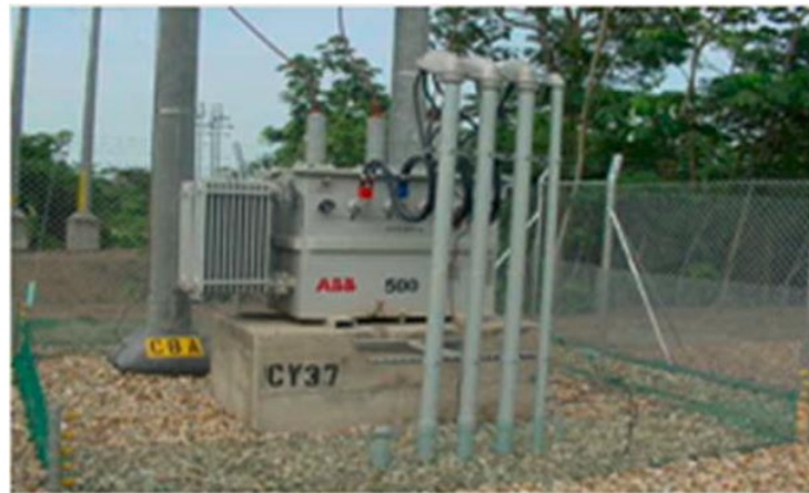
Figura 11: Transformador reductor (S.D.T)
