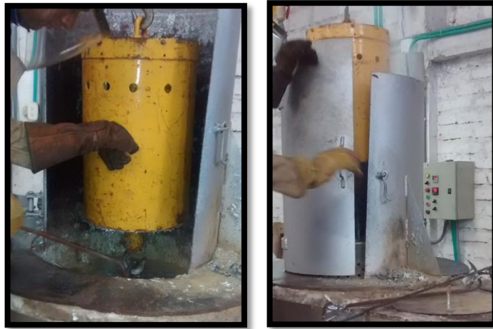
Figura 10. Etapa de galvanizado por centrifugado. (a) entrada en el baño del cinc. (b) salida del baño de cinc.
