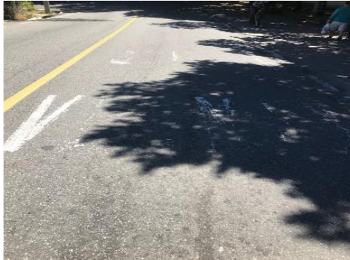
Figura 22. Señal horizontal en mal estado.
