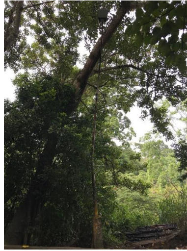
Figura 39. Luminaria en estado regular.
