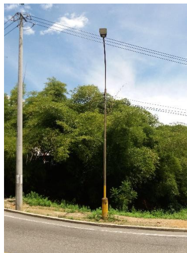
Figura 38. Luminaria en buen estado.
