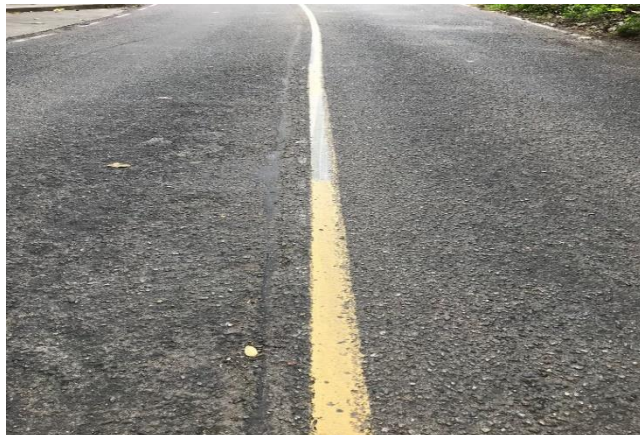
Figura 32. Pavimento en mal estado.
