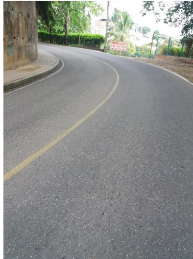
Figura 57. Requerimiento de señalización en el tramo KO+300 – k0+310.
