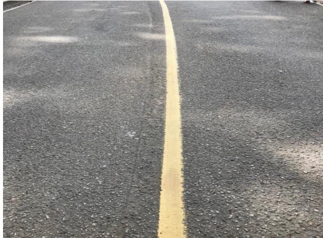
Figura 31. Pavimento en estado regular.
