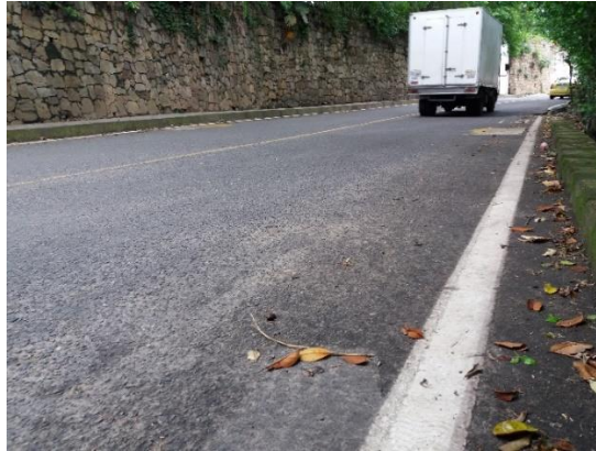
Figura 67. Falla tipo daña superficial-
