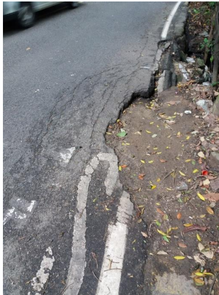
Figura 66. Falla tipo fisura en media luna.
