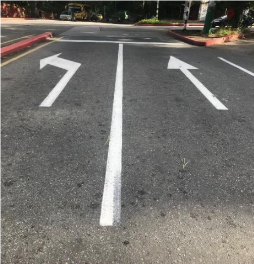
Figura 20. Señal horizontal en buen estado.
