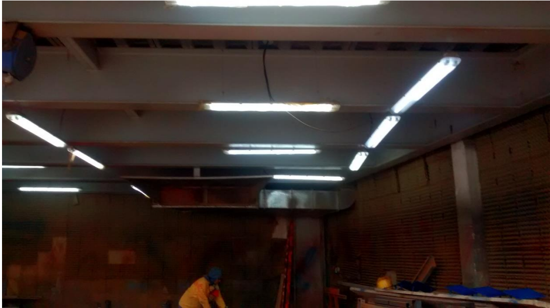
Figura 17. Cuarto de pintura y acabado de los elementos
