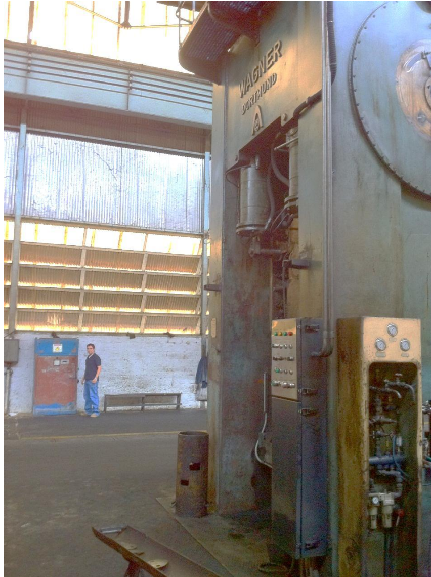
Figura 59. Ubicación del cofre de control y potencia
