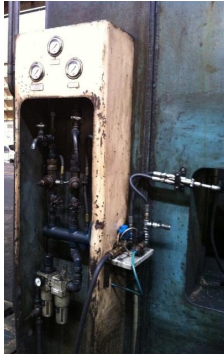
Figura. Distribuidor principal de Aire Comprimido
