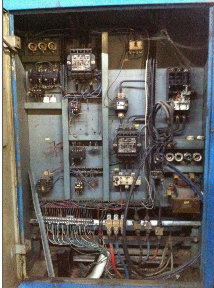
Figura 3. Estado inicial del cofre de control y potencia
