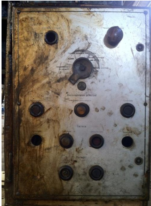
Figura 4. Estado inicial del panel de mando
