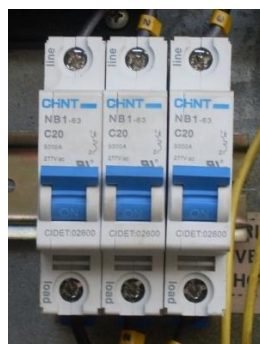
Figura 62. Interruptores monopolares de los ventiladores del A.A Luis A. Calvo
