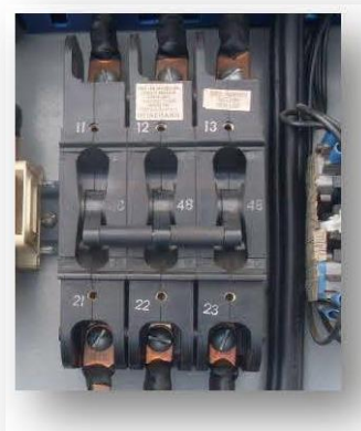
Figura 46. Interruptor termomagnético de un compresor del A.A Fundadores
