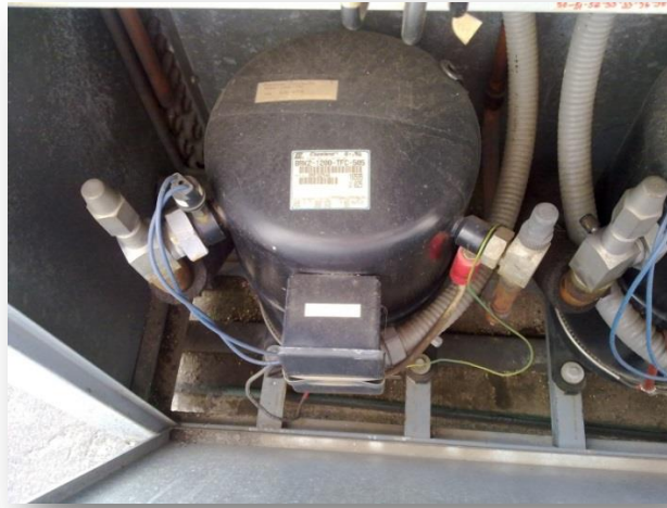
Figura 26. Compresores Unidad Condensadora A.A Auditorio Fundadores
