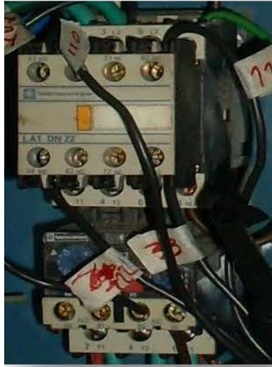
Figura 42. Contactor del motor del blower
