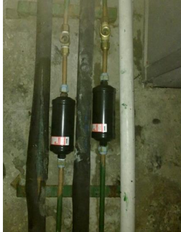
Figura 28. Válvulas de expansión A.A Fundadores
