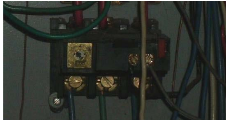
Figura 64. Relé de sobrecarga del motor del blower del A.A Luis A. Calvo
