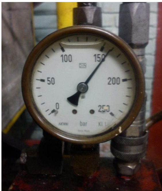
Figura 108 Manómetro válvula de seguridad Referencia autores del proyecto
