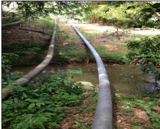
Figura 18 Cuerpos de agua observados en el trayecto de la línea de 8" de diámetro.
