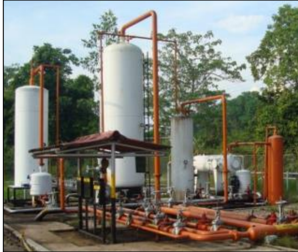
Figura 8 Estación de separación Peroles.
