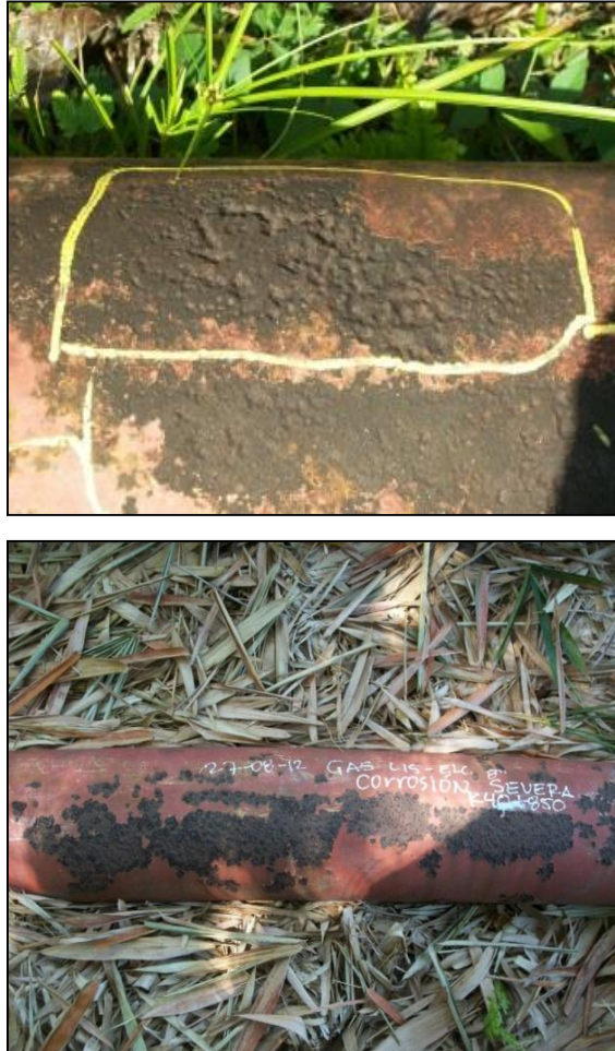
Figura 21 Corrosión externa observada en el trayecto de la línea de 8" de diámetro.
