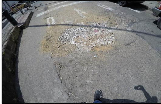
Figura 3. Estado del pavimento de la carrera 26 entre calles 9 y 10
