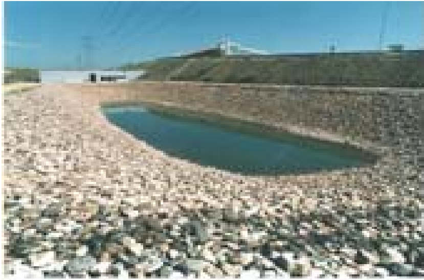
Fotografía 7. Laguna de estabilización de lixiviados Madrid 26
