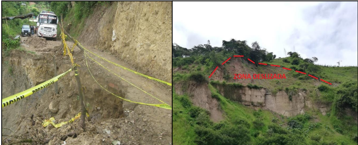
Figura 26. Deslizamientos en el talud de estudio
