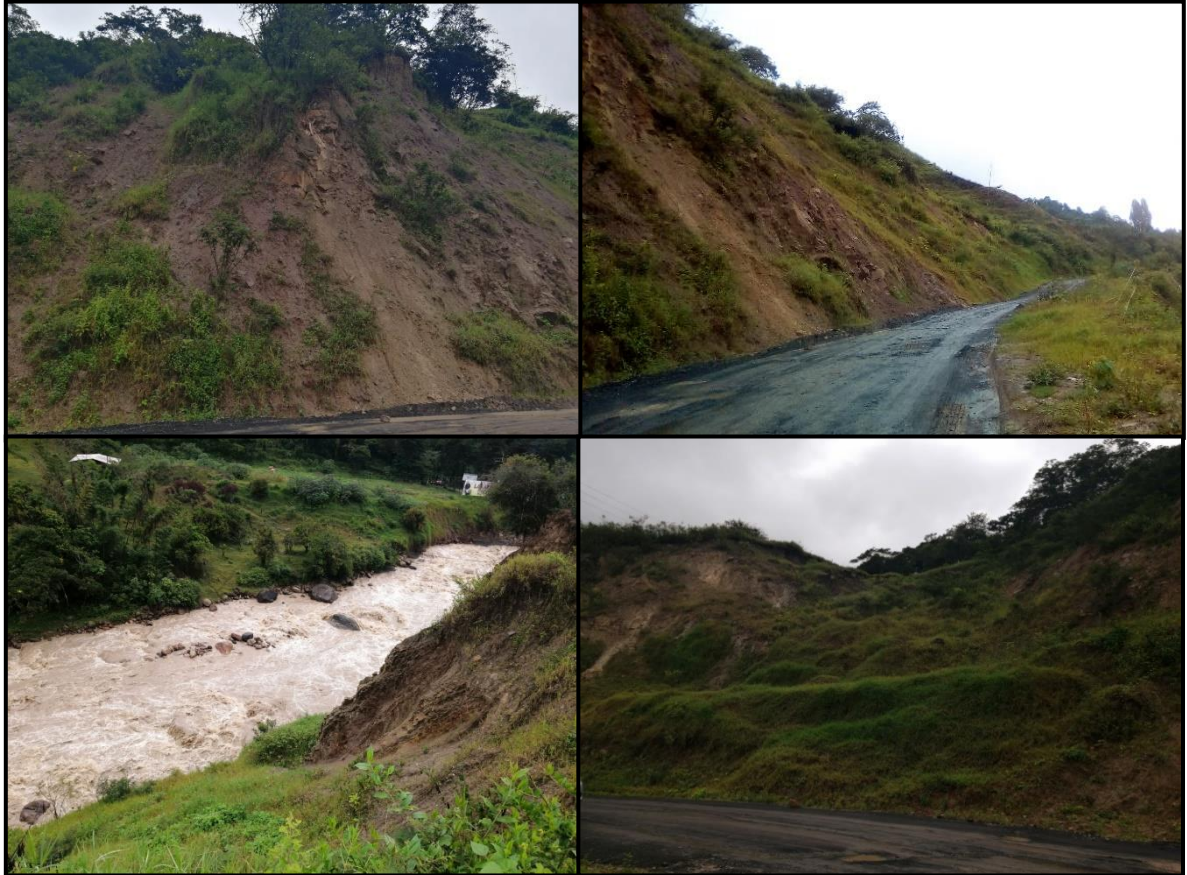
Figura 2 Estado actual del talud en estudio
