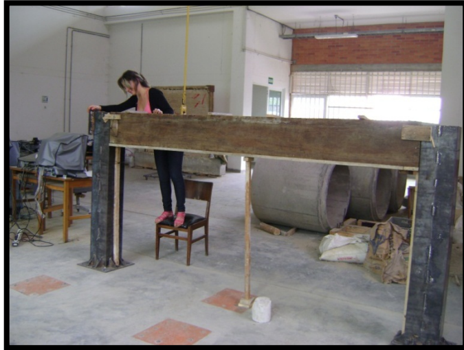
Fotografía 6.3. Ilustración de la construcción de la formaleta para la Viga de sección combinada
