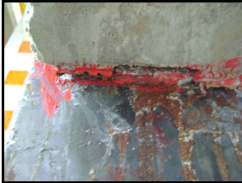
Fotografía 6.19 vista de la parte inferior del nodo 2.
