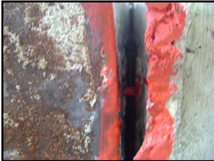
Fotografía 6.16. Vista lateral donde se observa la separación de la viga y la columna por falta de adherencia
