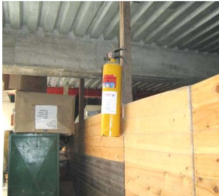
Figura 21 Extintor mal ubicado
