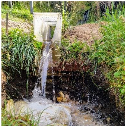
Transductores de presión y vertedero (TP)
