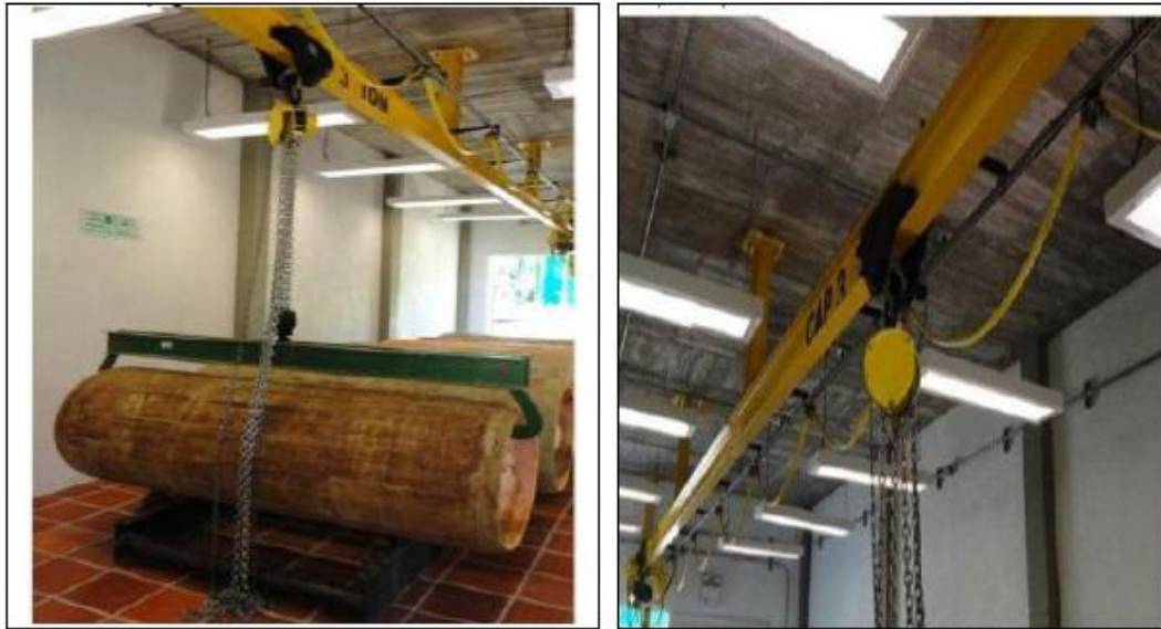
Figura 8. Mono riel y grúa.
