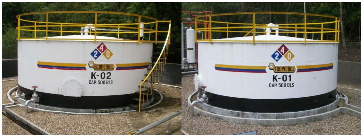
Figura 28: Tanques de almacenamiento K-01 y K-02.
