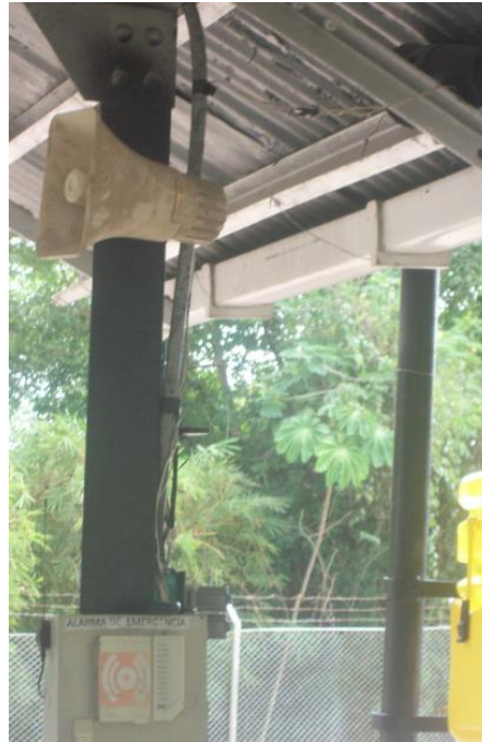
Figura 40: sistema de alarmas.
