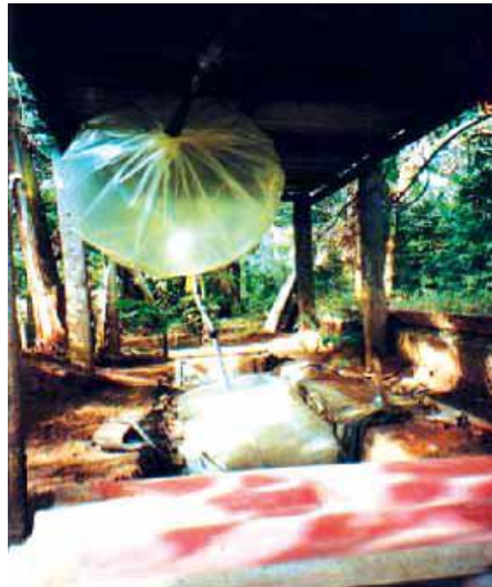
Figura 37. Reservorio de biogás
