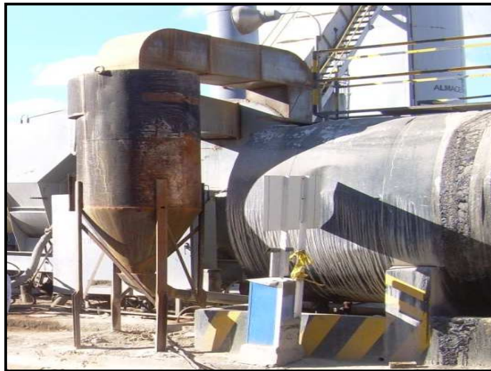
Figura 10. Sistema de extracción y lavado de gases
