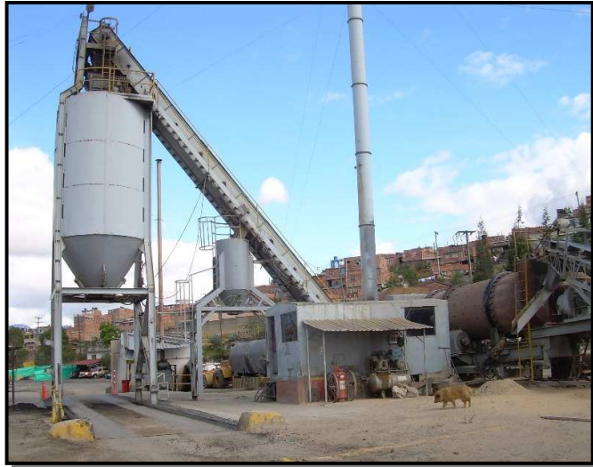
Figura 8. Sistema de alabes y silo de almacenamiento.
