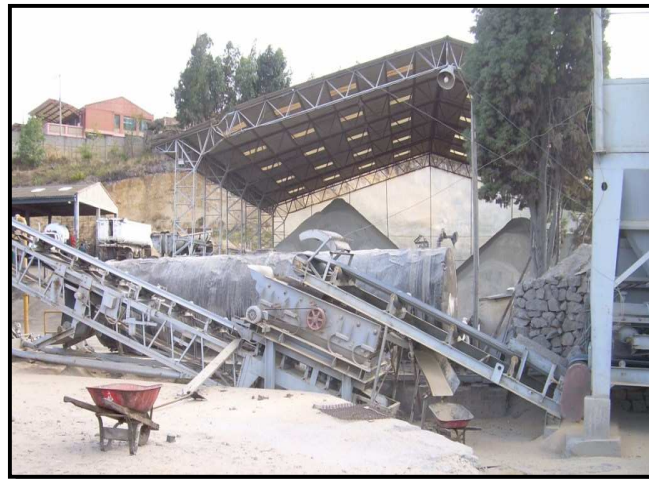
Figura 4. Banda transportadora central
