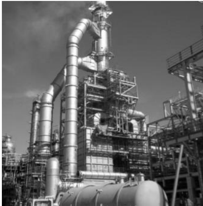
Ilustración 9. Aspecto general de un horno industrial
