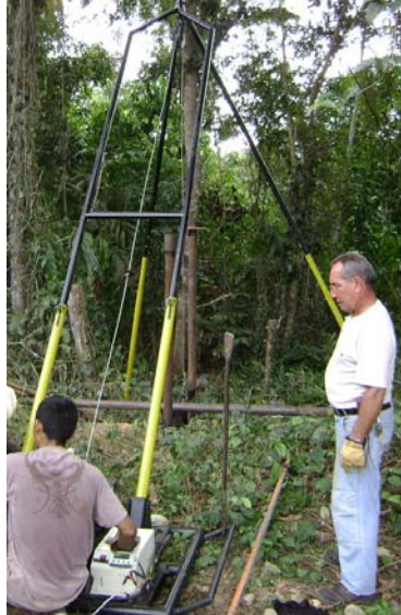
Figura 29. Trípode armado en campo durante pruebas hechas al equipo. En esta toma se observa que los planos de la máquina fueron muy cercanos a la realidad de construcción del trípode. Las partes amarillas de la fotografía son la parte inferior de cuatro tubos acerados provistos de una capa de tungsteno que ofrece alta resistencia al desgaste y a la deformación. [4]
