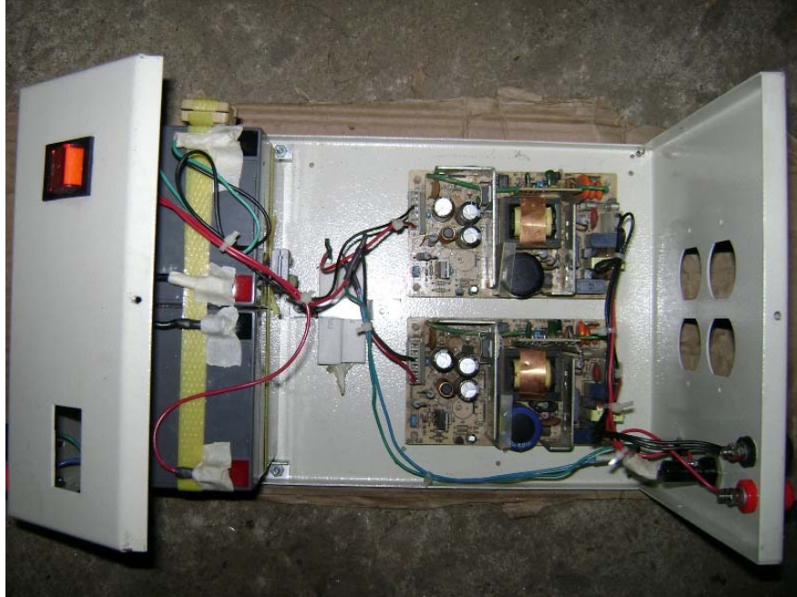
Figura 37. Fuente eléctrica con sus respectivas baterías en una caja de protección [4]
