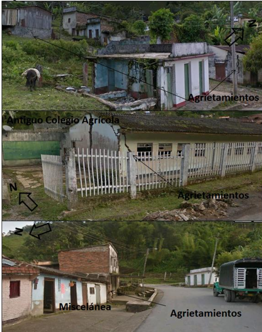
Figura 65. Agrietamientos presentes en las construcciones del Corregimiento de Alto Jordán.
