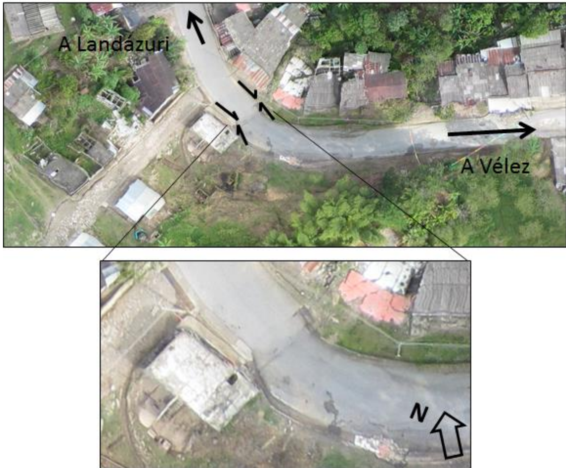
Figura 68. Desplazamiento sobre la vía de Alto Jordán a Landázuri.
