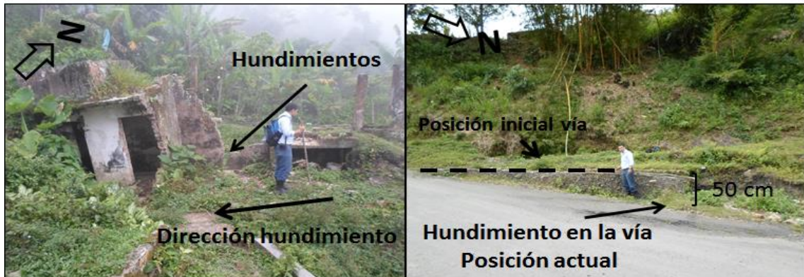
Figura 61. Hundimientos presentes en el Corregimiento de Alto Jordán.
