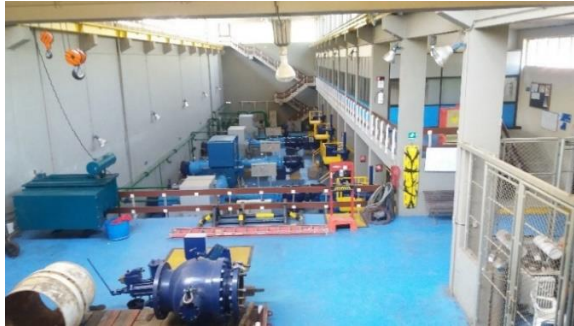
Figura 10. Cuarto de bombas
