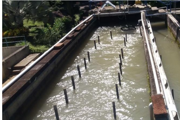
Figura 4. Aireación (canaleta parshall)
