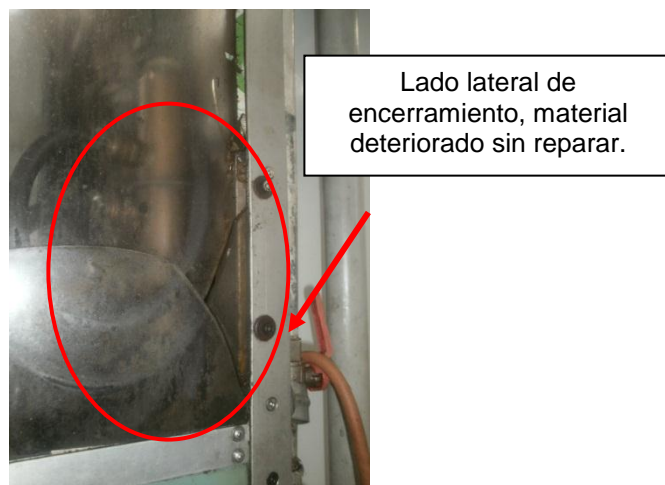
Figura 65. Vista lateral del encerramiento de la Tocco II.
