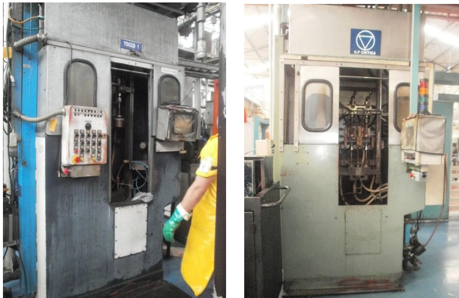
Figura 123. Estación de trabajo TOCCO I y II.
