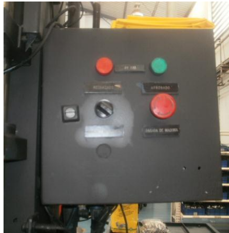
Figura 77. Tablero de control de la prensa.
