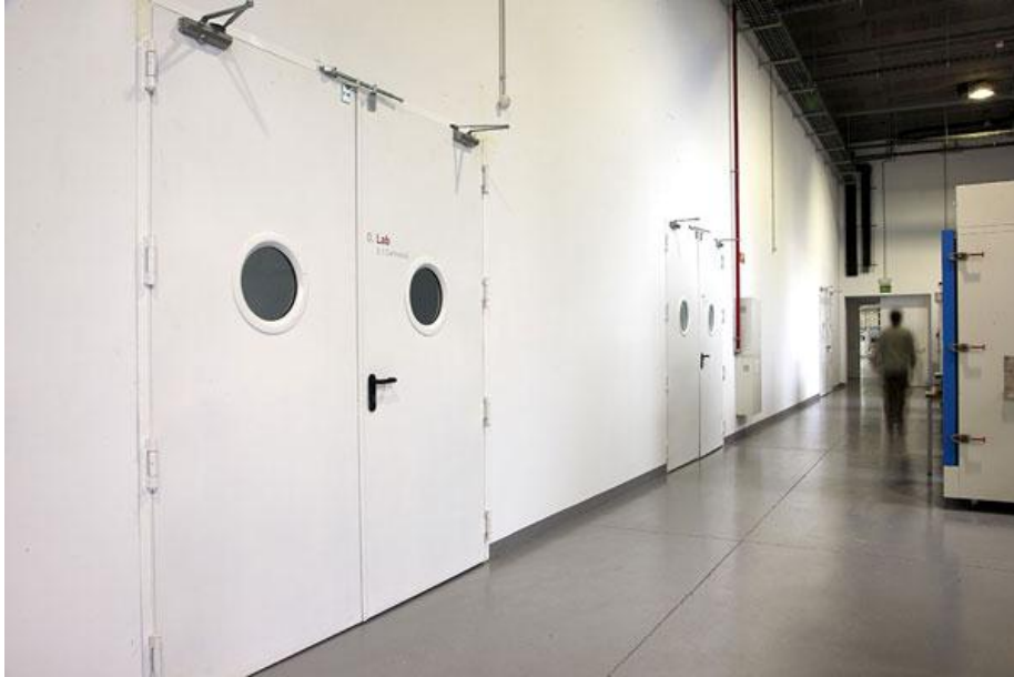
Figura 76. Portón cortafuegos del CIM
