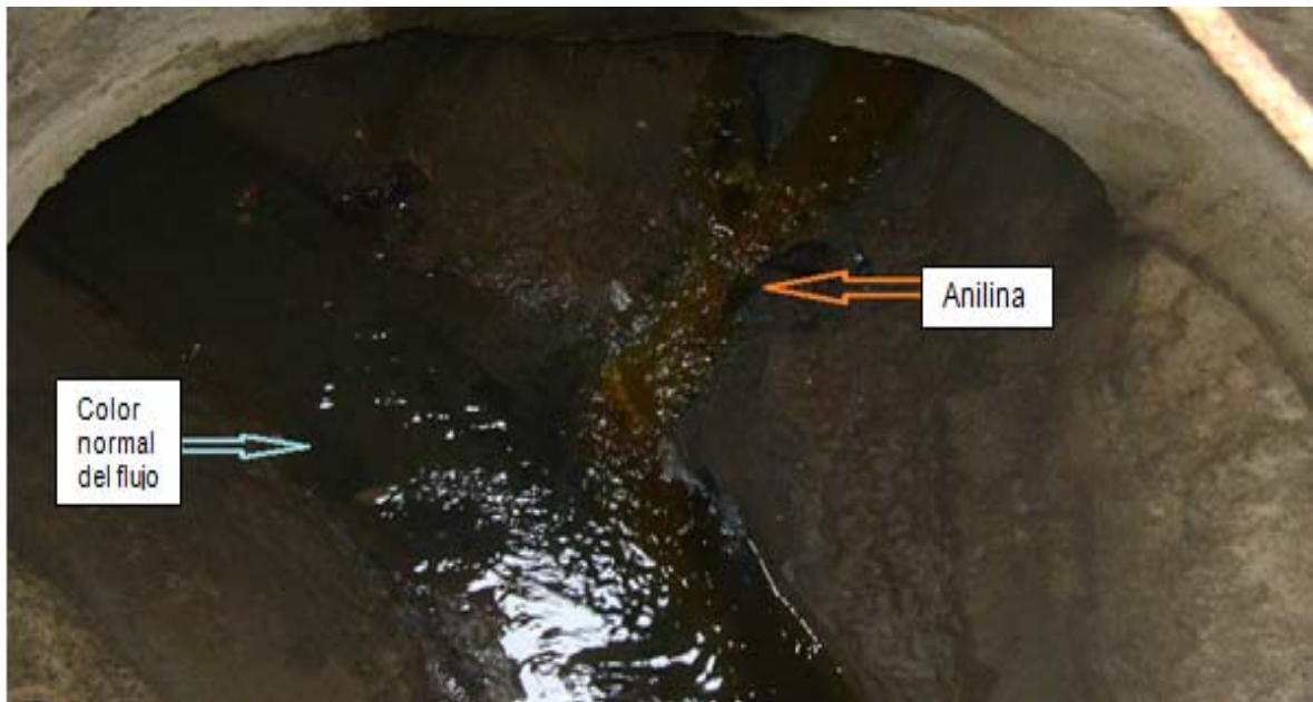
Figura 4 Vista de colorante en vivienda con conexión errada.
