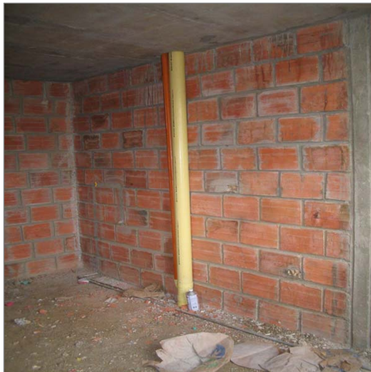
Foto 6. Detalle de Bajante aguas negras. Dotación viviendas Proyecto Paseo La feria.
