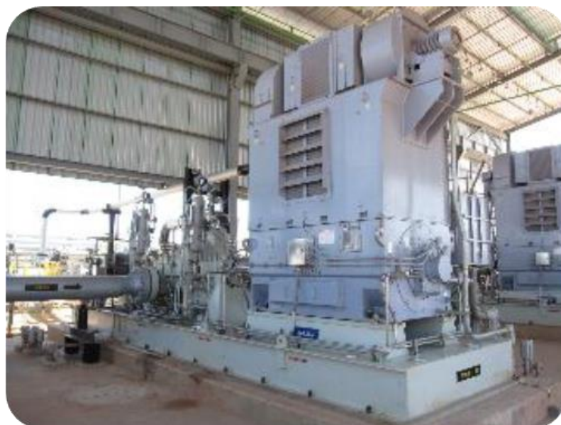
Figura 10. Unidad Principal de Bombeo de la Estación Corocora
