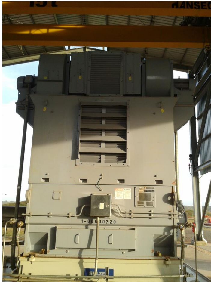
Figura 18 Motor eléctrico unidad principal
