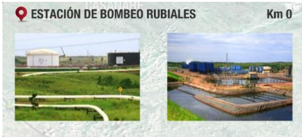
Figura 6. Área de Tanques Estación de Bombeo Rubiales
