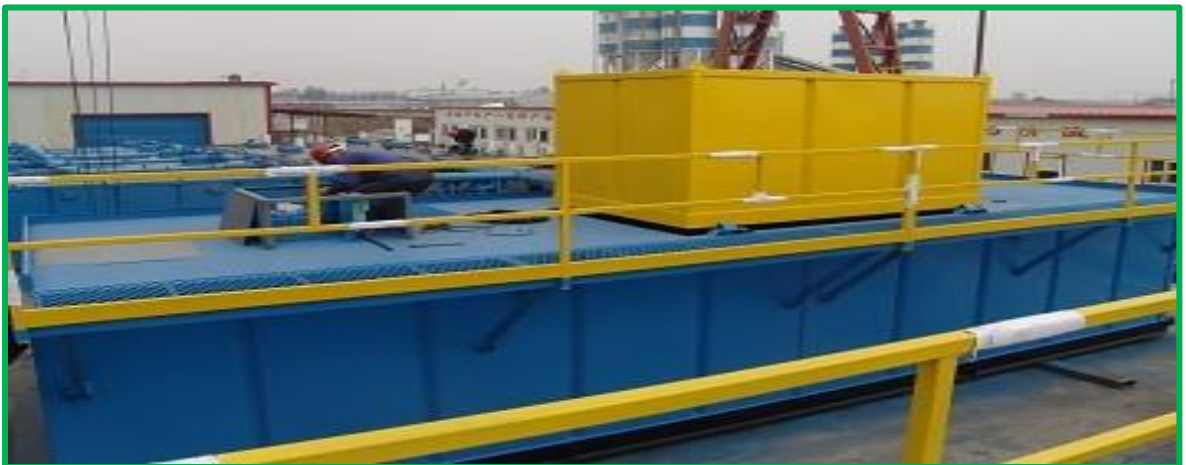
Figura 42. Tanque de mezcla.
