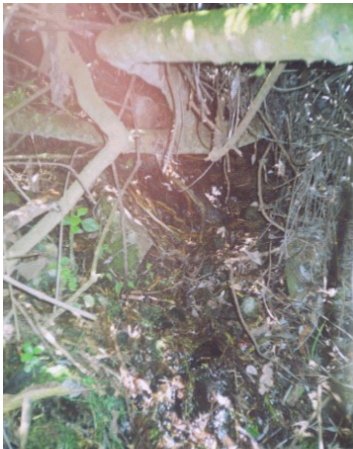
Foto 9 : Exfiltración en zona de raíces en N.REL.
