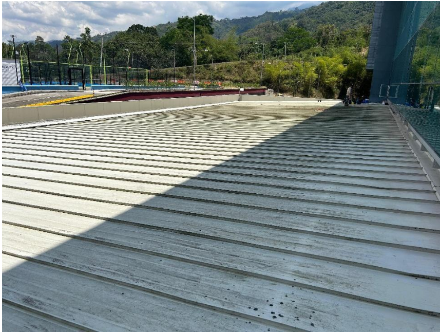
Figura 3. Zona sin impermeabilizar
