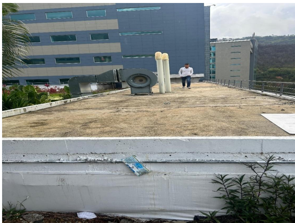
Figura 1. Zona sin impermeabilizar
